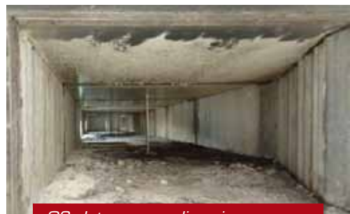
03 - Interno canalizzazione sporca
