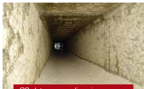
02 - Interno canalizzazione sporca
