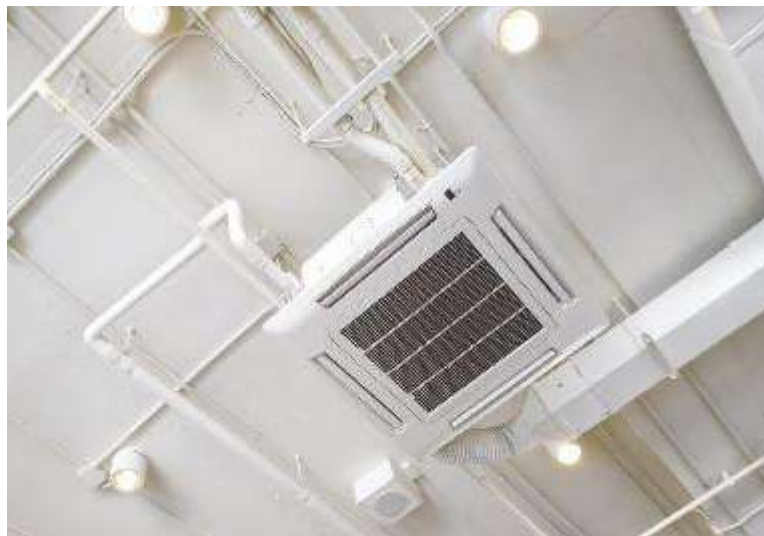
↑ Gli impianti di ventilazione meccanica devono essere tenuti accesi
